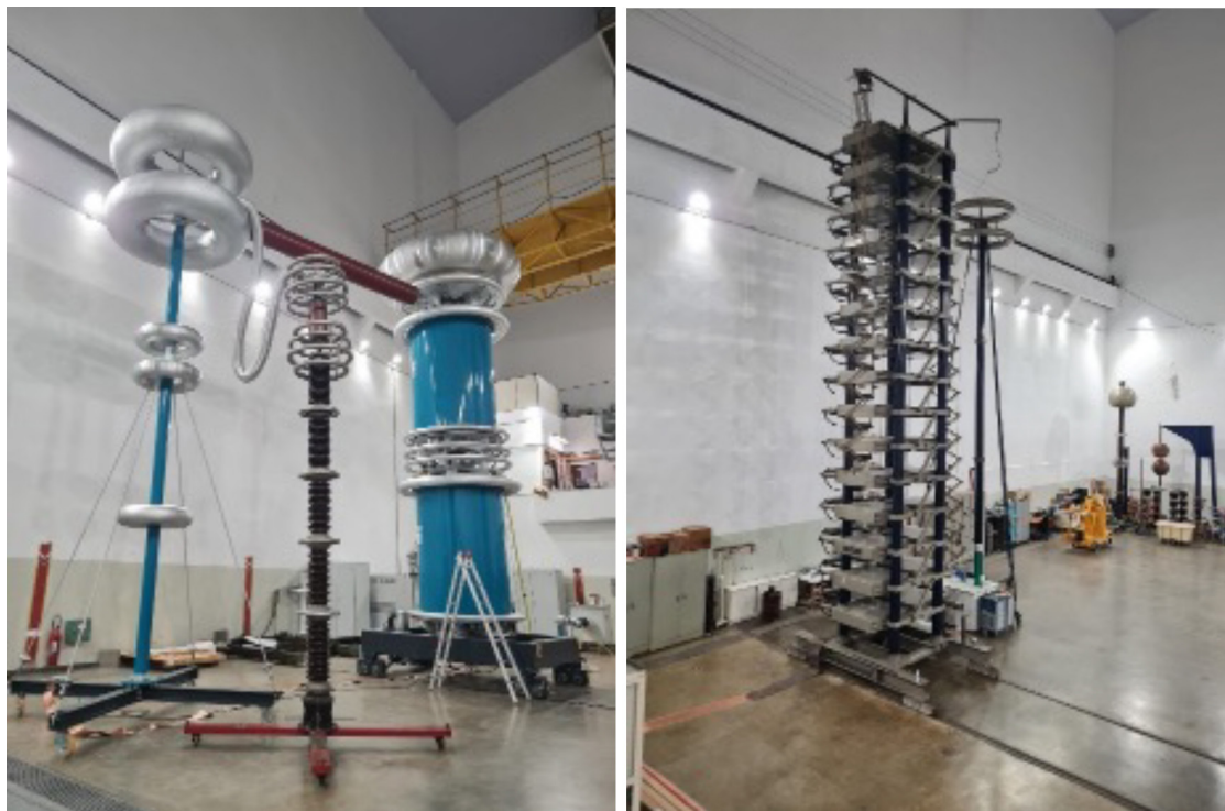
Fotos 02 e 03: Fonte de Alta Tensão em 60 Hz e Gerador de impulsos
